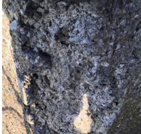
sich zersetzender Beton
