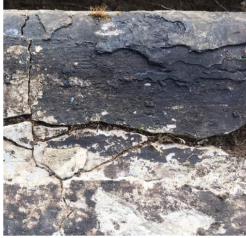
Vegetation und Rissbild
