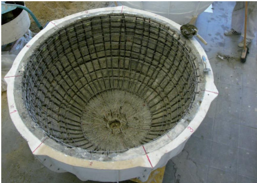
Sichtbetonkonservierung in der österreichischen Denkmalpflege
