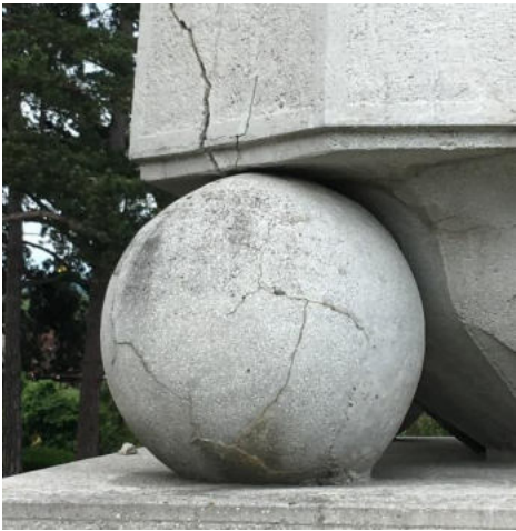
Risse (Statik u. Rost)
