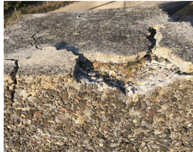
zu fester Betonüberzug
